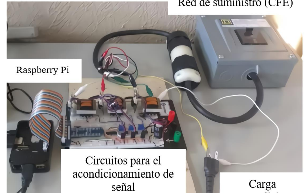
Red de suministro (CFE)
